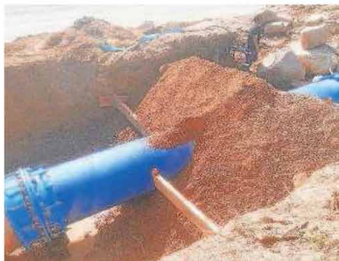
Rotura en la N-VI (Guadarrama) // CVII
