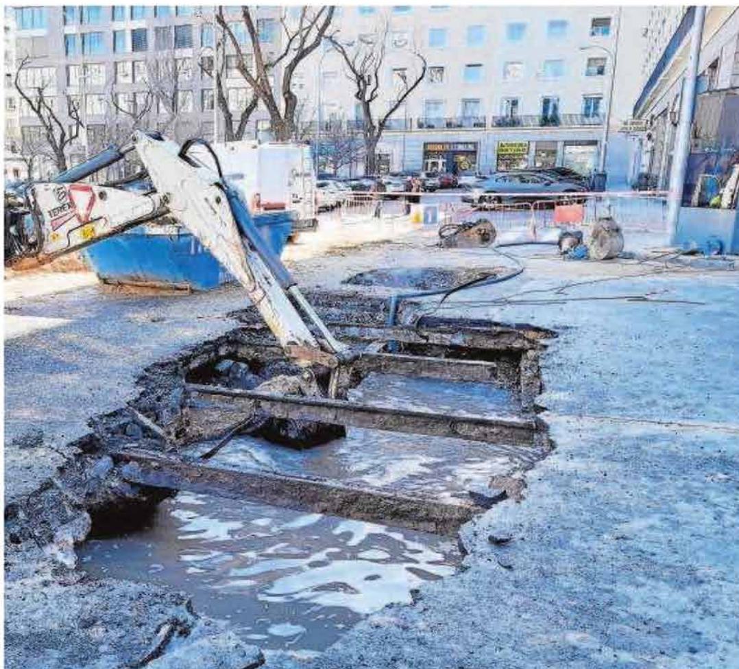
Un equipo interviene en una rotura de tubería en plena ciudad // CVII
