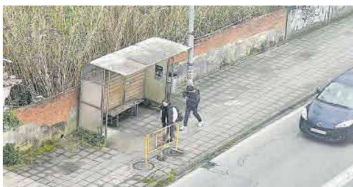
Socavón vallado en la parada del autobús. | G.Núñez
